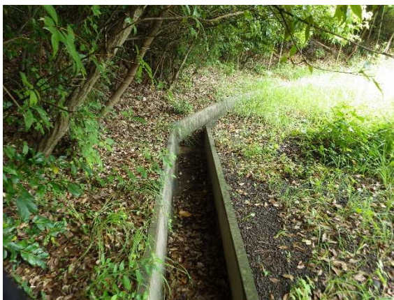
多目的広場の側溝 幅 40cm、深さ 30cm、未対策部 (2020.9.15)
