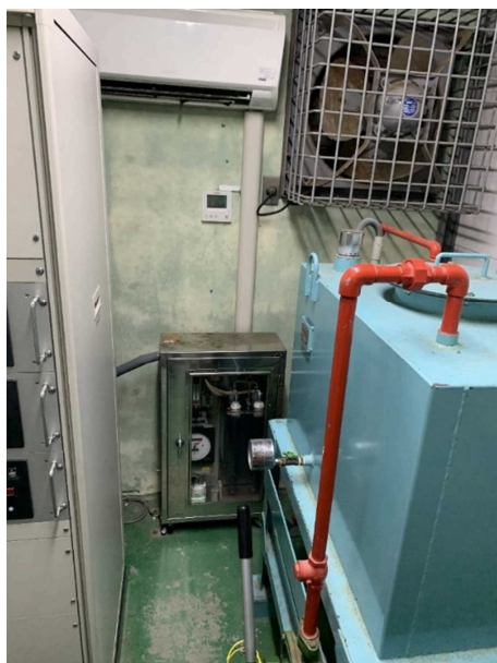
写真4 白砂局舎内の状況
