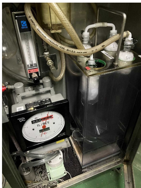
写真1 カラムの破損状況
