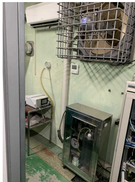
写真5 平場局舎内の状況
