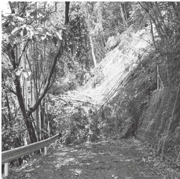
地藏峠停車場線の崩壊状況(神尾地区)
