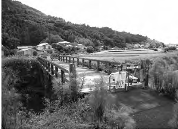
通行に支障があると判断された木造橋
