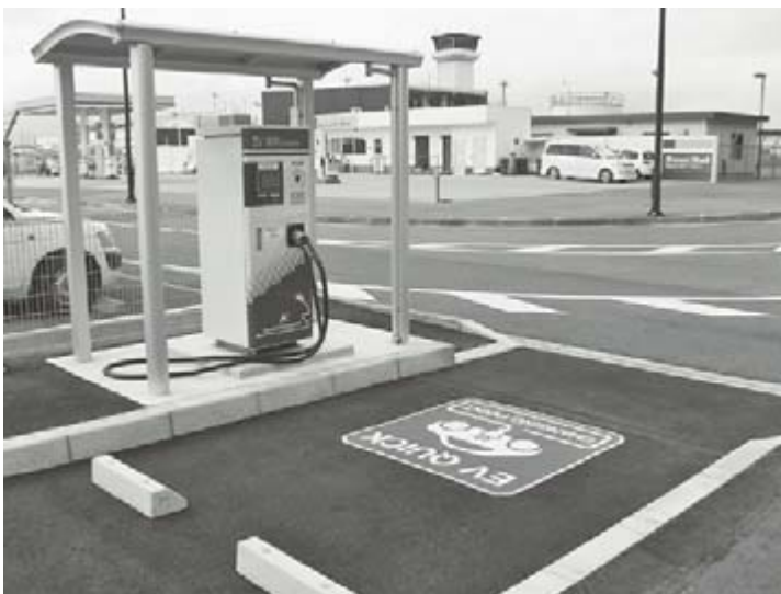
電気自動車の急速充電設備 (富士山静岡空港)
