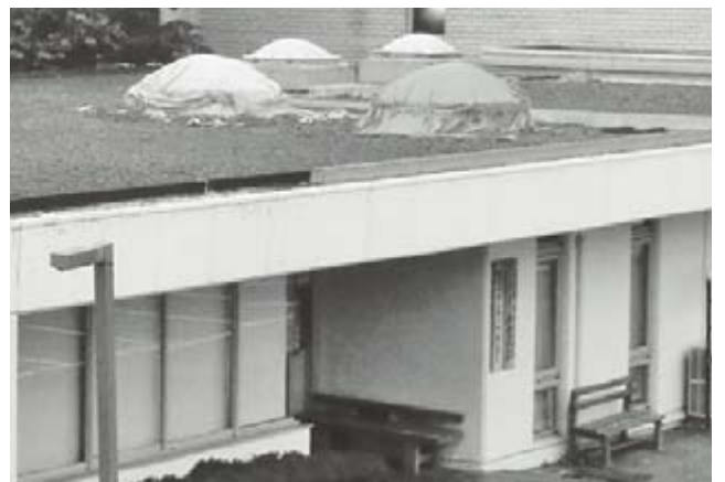
雨漏りのする障害者支援福祉施設
