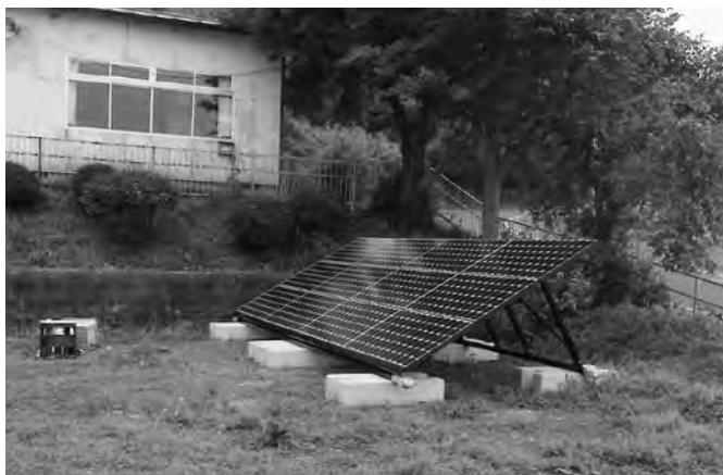
避難所に設置された太陽光発電施設 (石巻市雄勝町)
