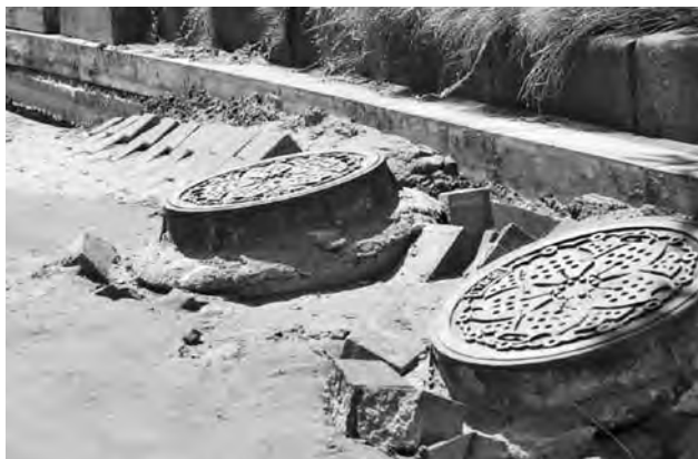
液状化現象により持ち上がったマンホール
