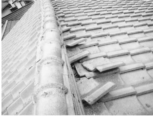
駿河湾地震で屋根瓦が壊れた家
