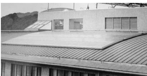
太陽光発電設備 (保健福祉センター はなみずき)
