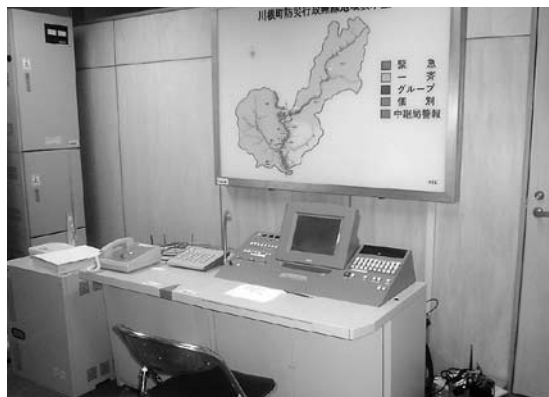
川根支所同報無線放送室
