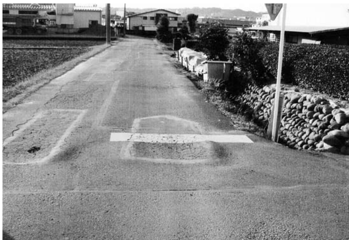
再舗装の時期を迎えている市道
