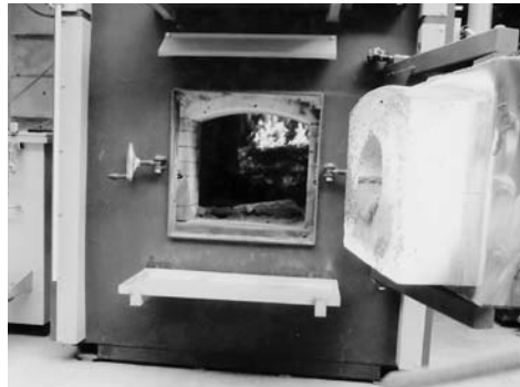
木質バイオマスエネルギーの利活用 (木質チップボイラー)
