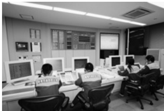
消防通信事務委託をする焼津市の通信指令室
