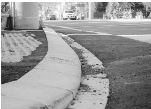
大きなバリアーとなっている歩道と車道の3cmの段差
