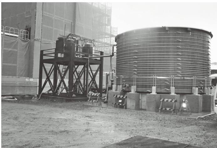
新設された川根温泉の木製貯湯タンク
