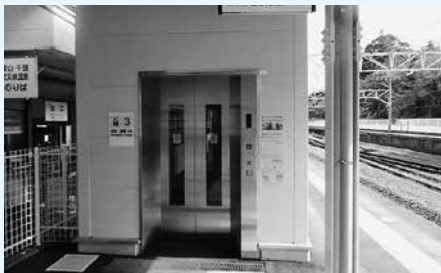
金谷駅に設置されたエレベーター
