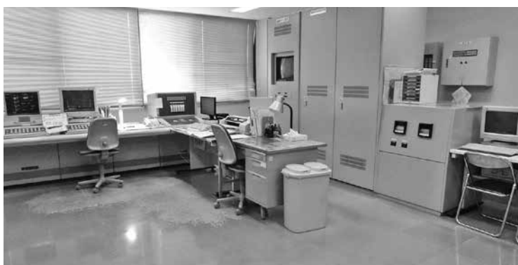
浄化センター建設工事の一部である制御コンピューター
