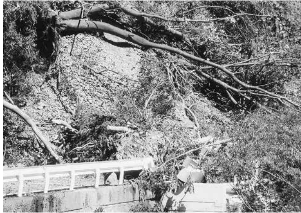
台風による被害箇所
